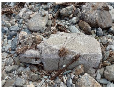
La partie détruite du seuil retrouvée un peu en aval
